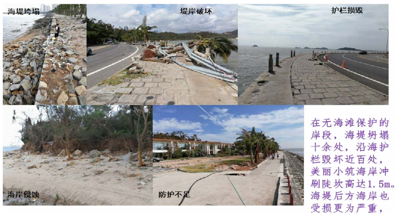
图 20 无沙滩保护的岸段，台风过后堤岸垮塌、护栏损毁 (图片来源：自然资源部第三海洋研究所)
